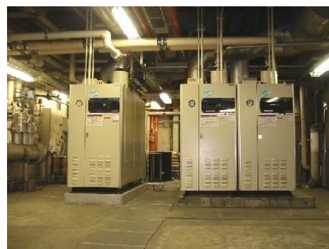
都市ガス燃料ボイラー(小山工場)
