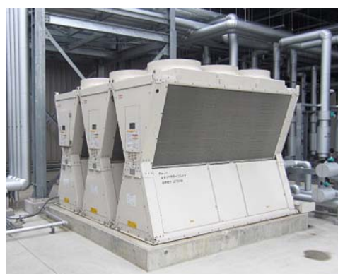
空冷ヒートポンプ
