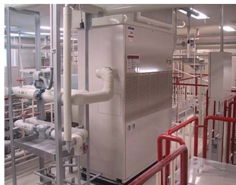
代替冷媒使用空調機(小山工場)
