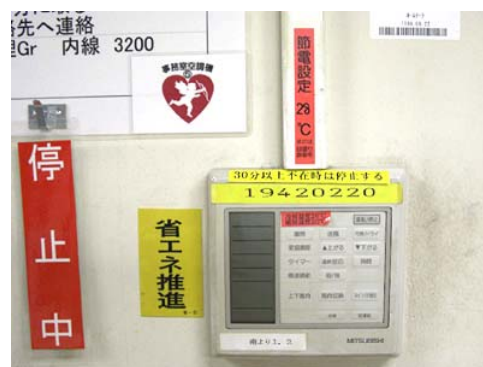
(空調機コントローラー塚口工場)
