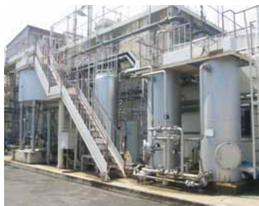
排水処理設備（塚口工場）
