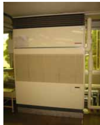
代替冷媒使用空調機（中京工場）
