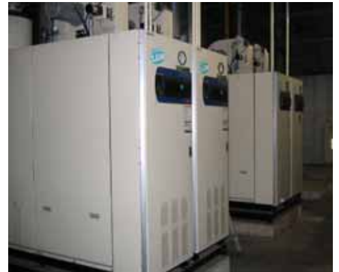
低Noxボイラー（鶴見工場）
