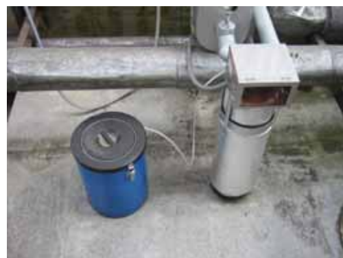
冷却塔軟水器(小山工場)
