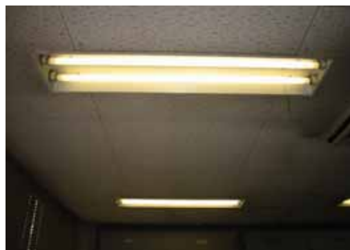
インバータ対応照明器具(小山工場)
