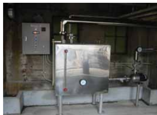
蒸気ドレン水回収装置(塚口工場)
