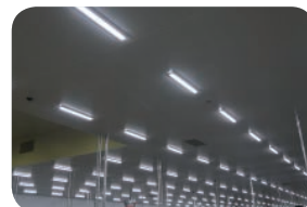
高崎森永株式会社第一工場 LED照明化
