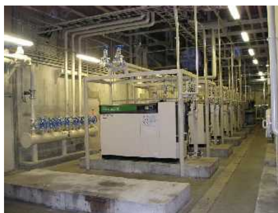
空気圧縮機(鶴見工場)
