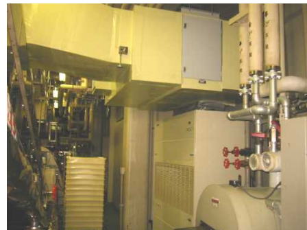
代替冷媒使用空調機(小山工場)
