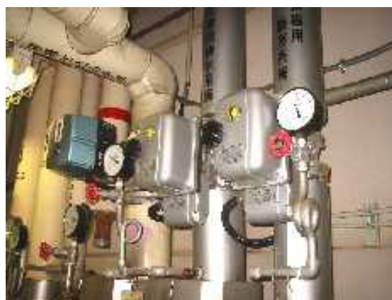
蒸気自動送気システム(小山工場)
