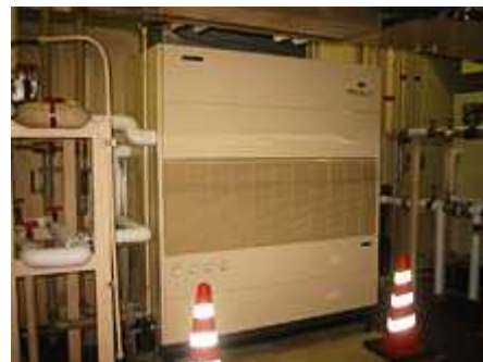
代替冷媒使用空調機（小山工場）
