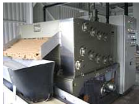
汚泥脱水機（森永デザート）
