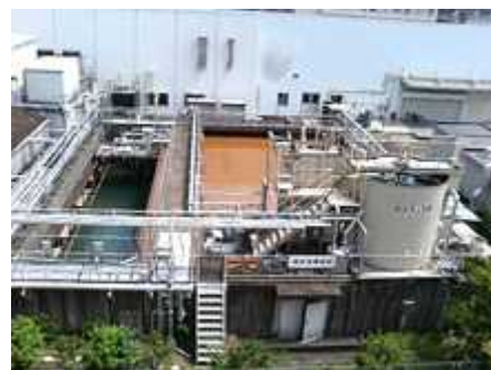
排水処理設備（鶴見工場）
