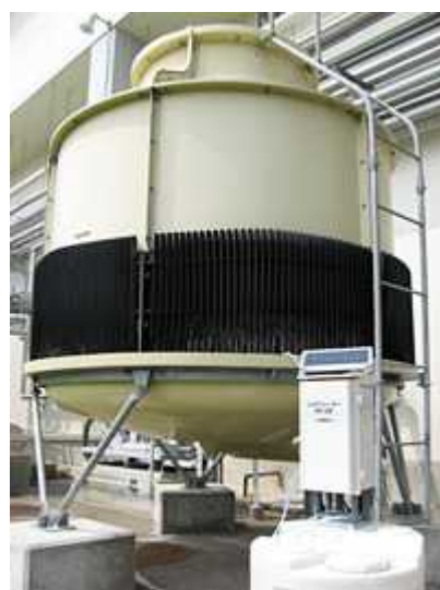
ソーラーパネル電源(中京工場)
